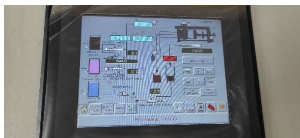
HMI PLC de deshidratación
