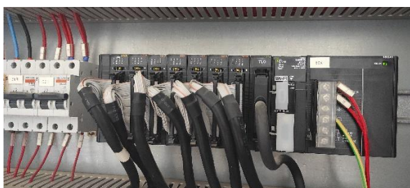
PLC de edificio de control
