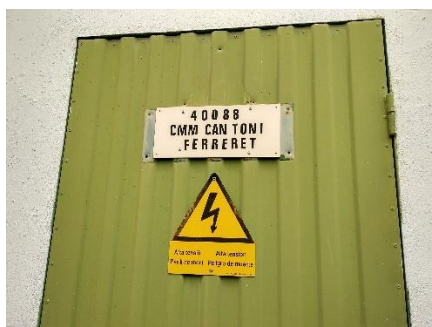
Centro de transformación
