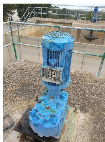
Reductor turbinas aireación
