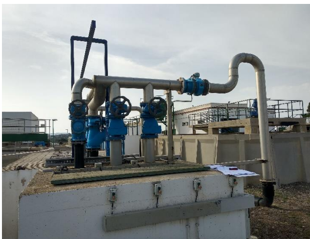
Bombeo de recirculación y exceso
