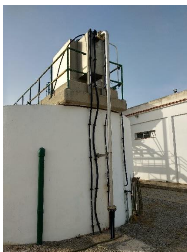
Camara de mezcla y floculación
