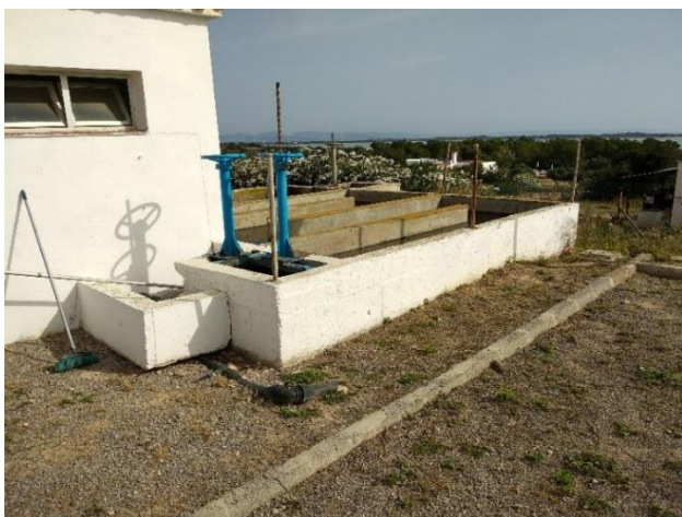
Camara de cloración
