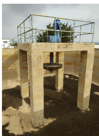
Turbinas de aireacion
