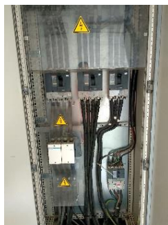
Cuadro general de baja tensión
