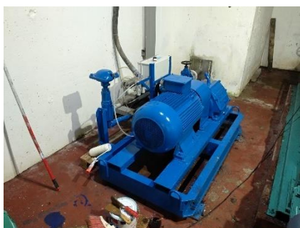
Bombas de poli
