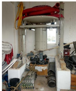
Extractor y dosificador de cal
