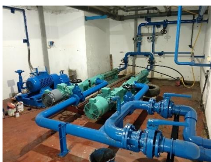
Bombas de fango
