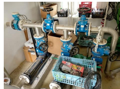
Bombas de recirculación fango
