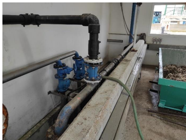
Aireación y bombeo de fosas sépticas
