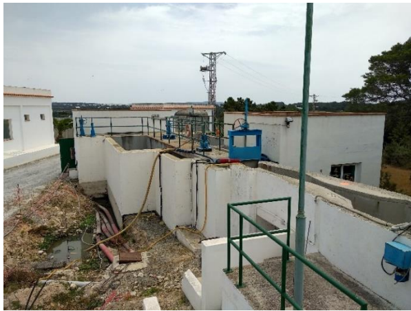
Tratamiento físico-químico y canal parshall
