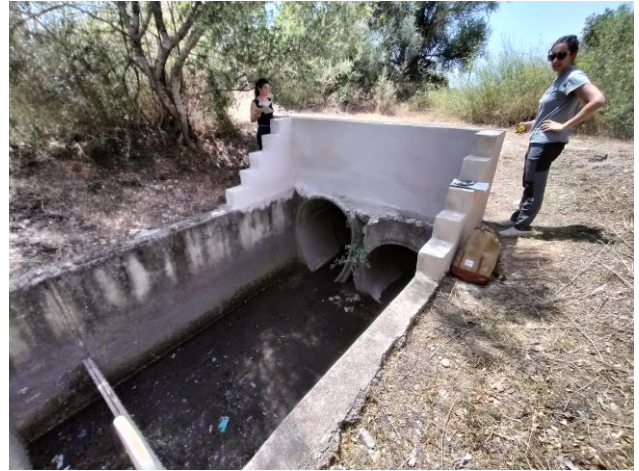
Figura 15 Tubos del aliviadero
