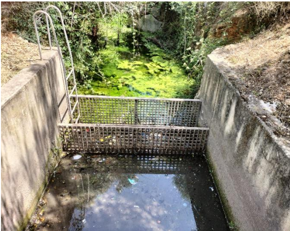
Figura 22 Actual reja para la retención de sólidos
