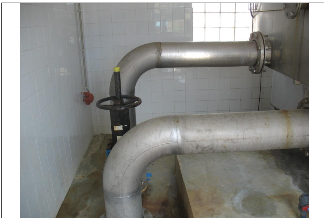
FOTO Nº22 Entrada de agua y salida hacia la Laguna de aireación.
