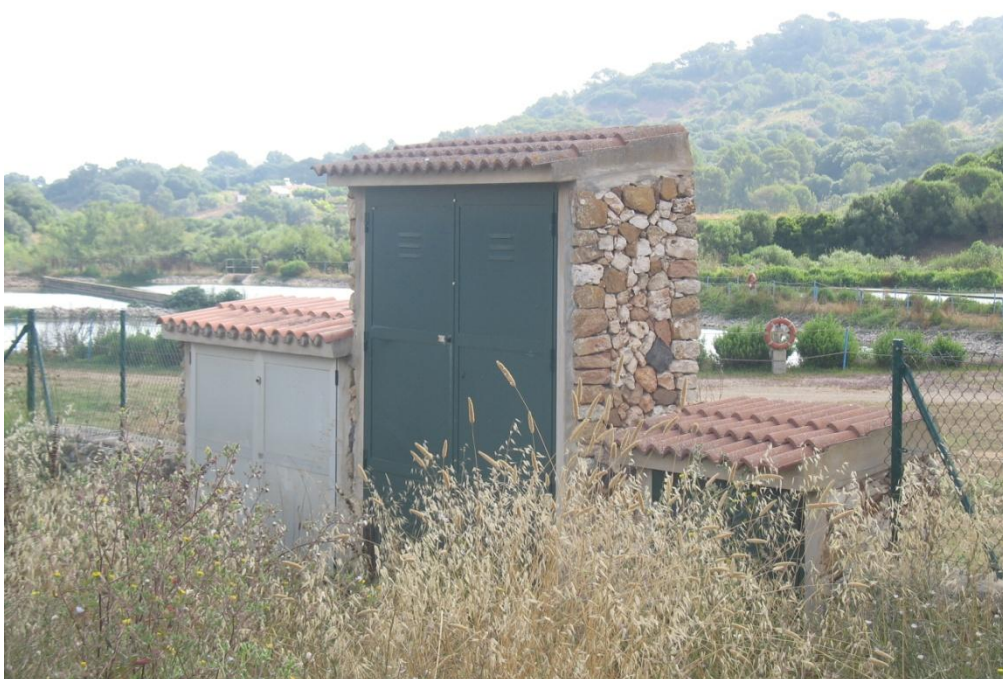
FOTO Nº58 Cuadros de entrada y contadores.
