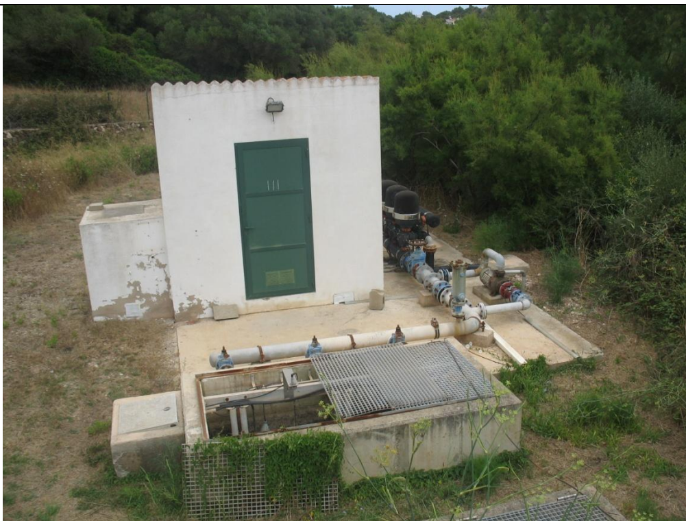
FOTO Nº53 Instalaciones de bombeo para reutilización del agua depurada hacia balsa de riego.
