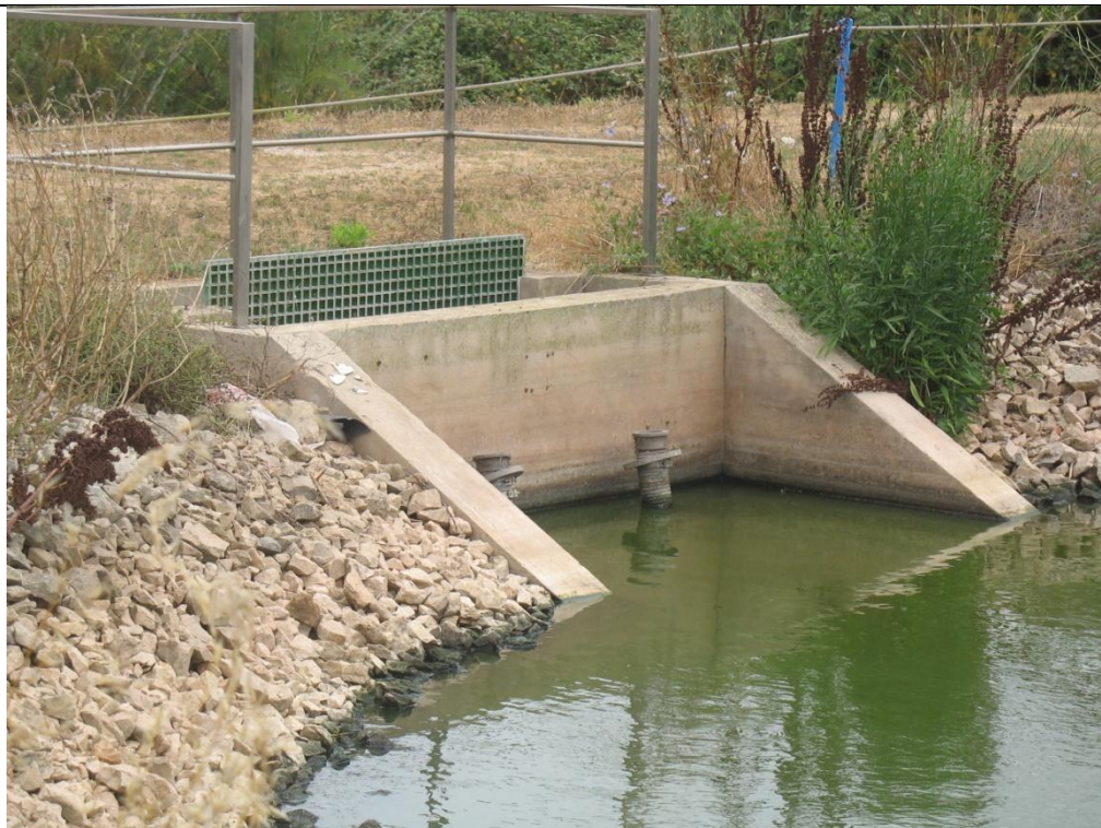
FOTO Nº45 Antiguas bombas de recirculación de la Laguna IV.
