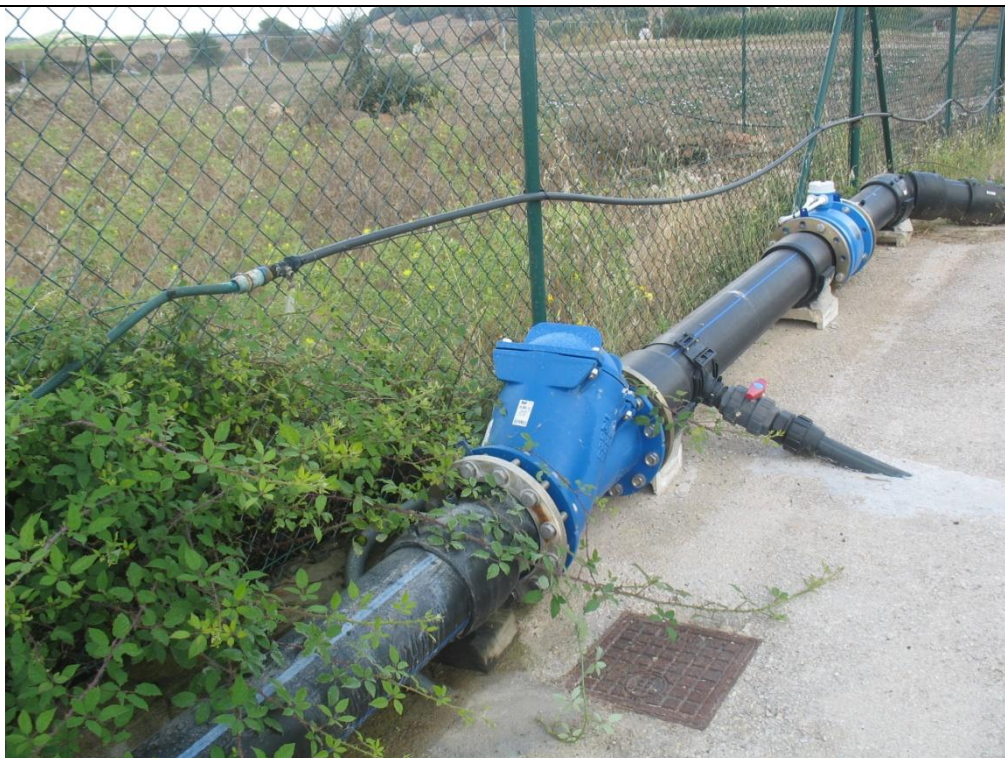
FOTO Nº11 Válvula anti-retorno y caudalímetro de la impulsión de Sta. Victòria.
