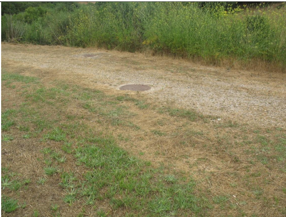
FOTO Nº41 Pozos de registro de la conducción de la Laguna III a la IV.
