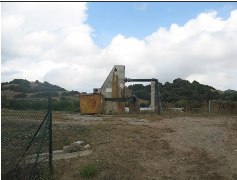
FOTO Nº13 Tamiz de finos del agua procedente de la EDAR Sta. Victòria.
