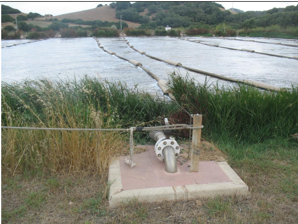
FOTO Nº18 Detalle de las tuberías de aireación.
