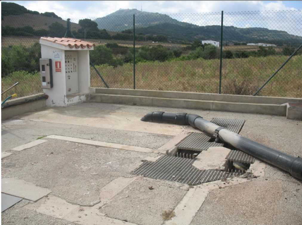
FOTO Nº4 Zona de entrada del agua y desbaste de agua bruta del núcleo de Es Mercadal. La tubería es la llegada de la impulsión de Sta. Victòria.
