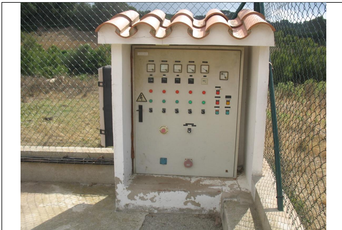
FOTO Nº9 Cuadro eléctrico del pozo de bombeo de entrada.
