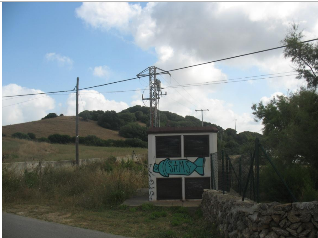
FOTO Nº56 Columna de línea eléctrica de acometida a la EDAR.
