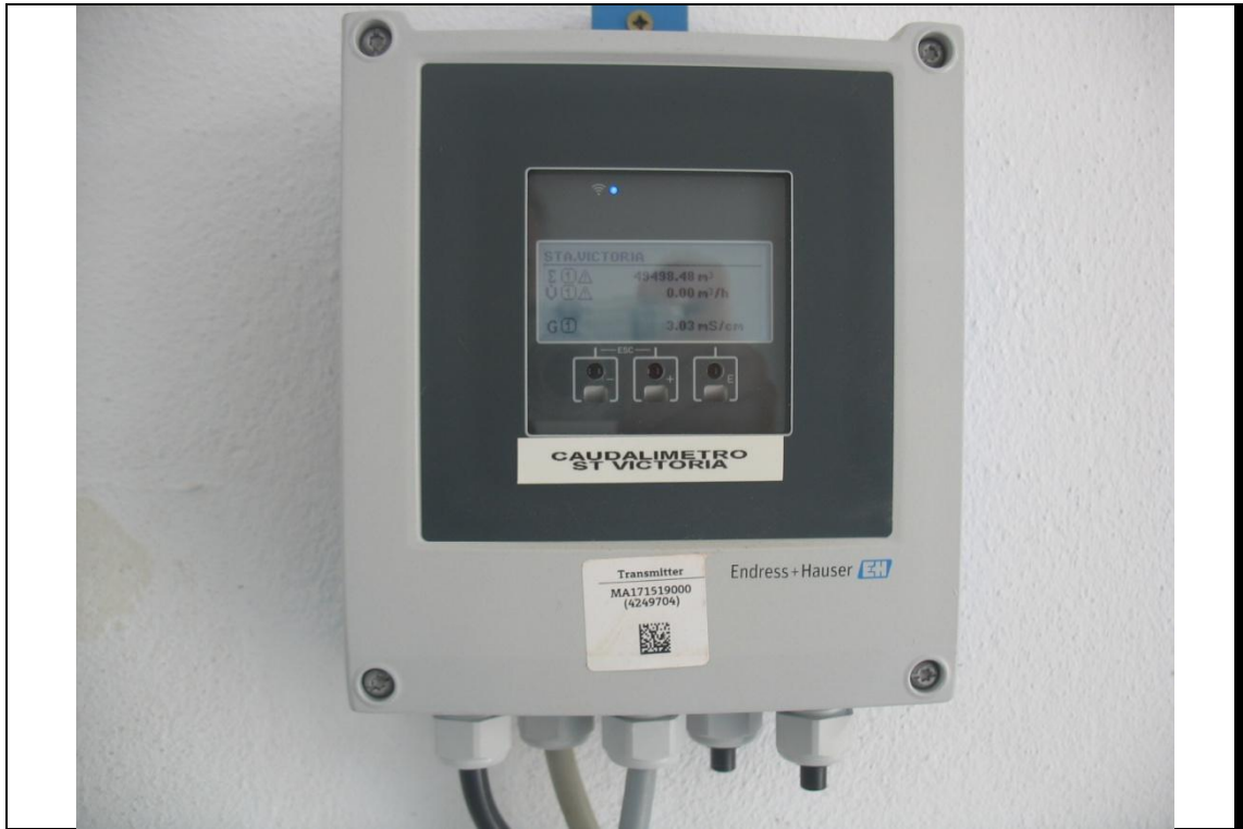
FOTO N°31 Display caudalímetro Sta. Victòria.
