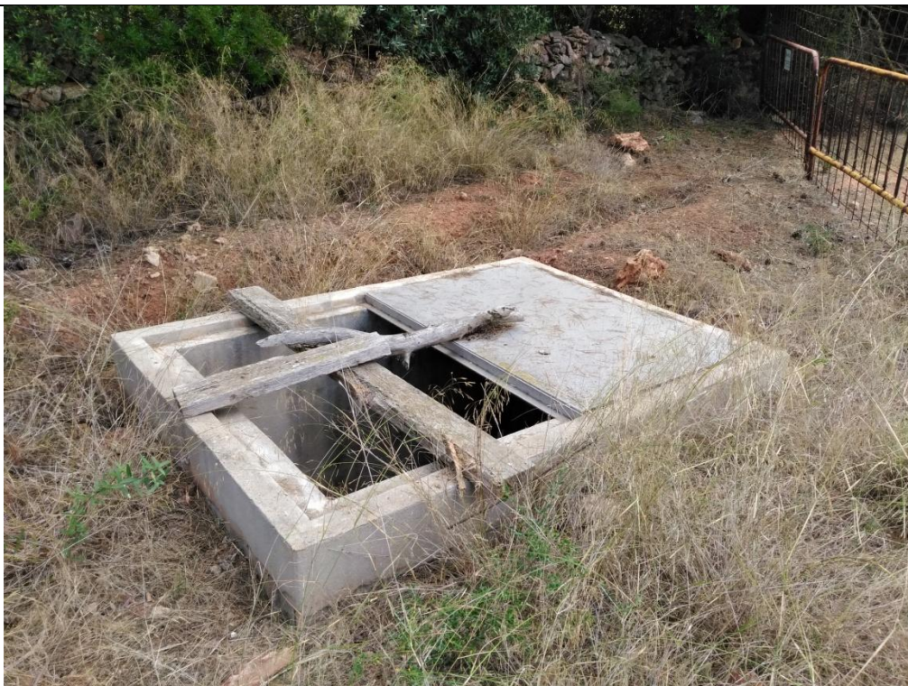
FOTO Nº65 Arqueta de punto de unión entre la conducción nueva y antigua aguas abajo de la EBAR Sta. Victòria.
