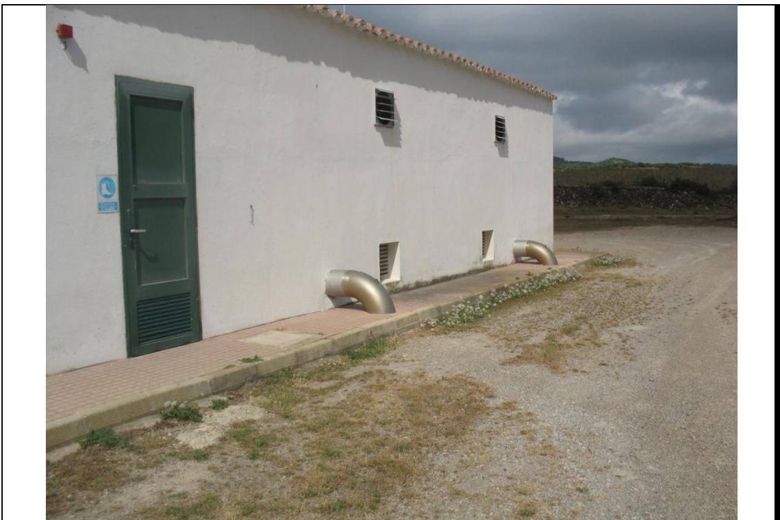
FOTO Nº20 Salida de las tuberías de aire hacia la Laguna de aireación.
