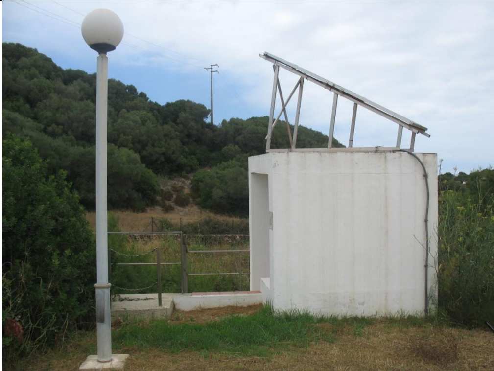
FOTO N°47 Caseta de tratamiento terciario.
