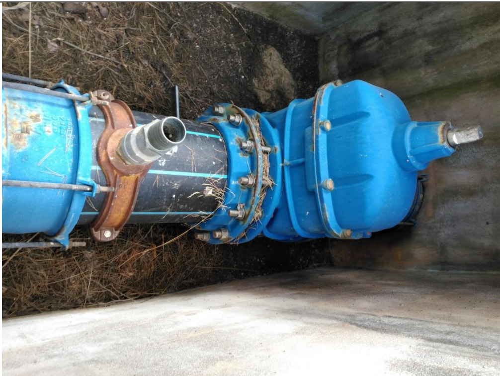
FOTO Nº66 Válvulas en el punto de unión entre la conducción nueva y antigua aguas abajo de la EBAR Sta. Victòria.
