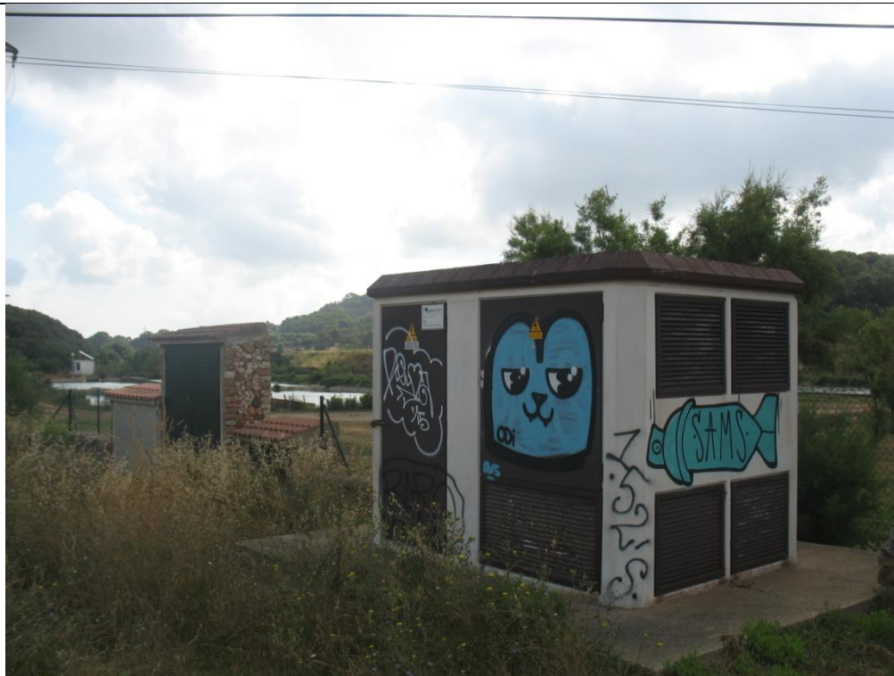
FOTO Nº57 Centro de transformación.
