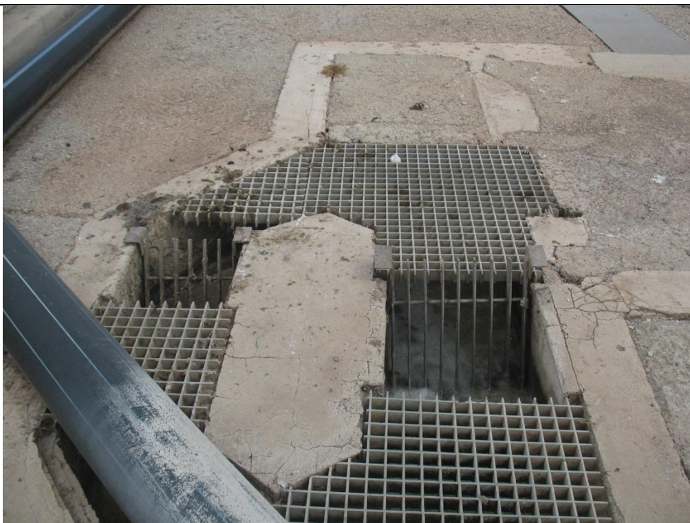
FOTO Nº6 Detalle de las rejillas.
