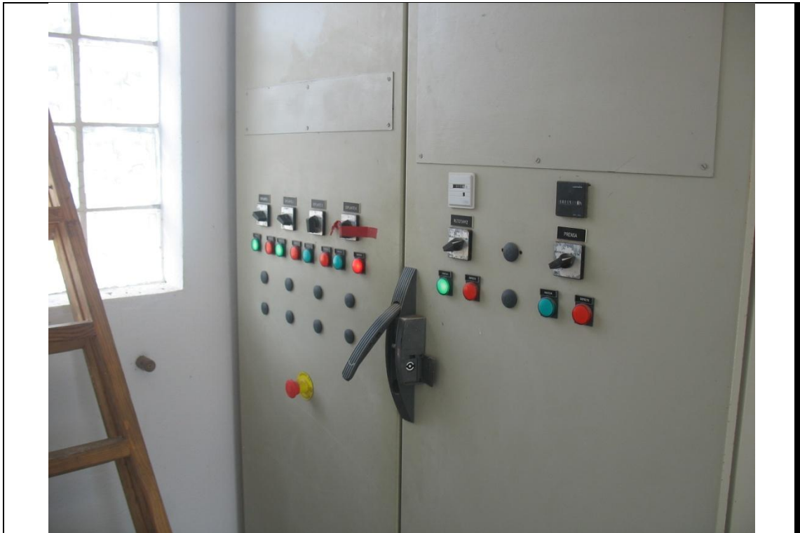
FOTO N°27 Cuadros eléctricos de las soplantes y tamiz.
