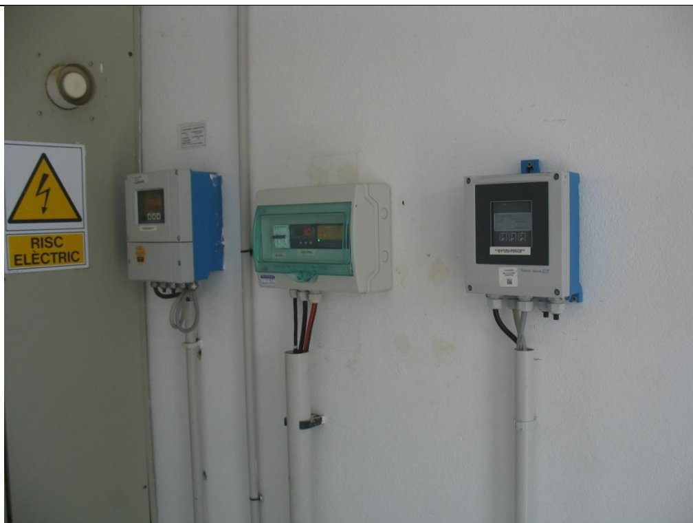
FOTO Nº26 Display de los caudalímetros de agua de entrada de Es Mercadal y Sta. Victòria.
