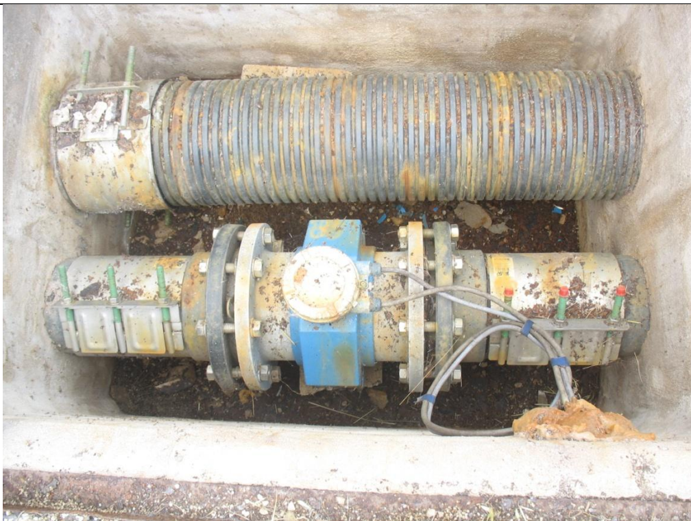
FOTO Nº25 Conducción de impulsión del pozo de bombeo al tamiz de finos del núcleo de Es Mercadal (con caudalímetro) y conducción de salida del tamizado hacia la Laguna de aireación.
