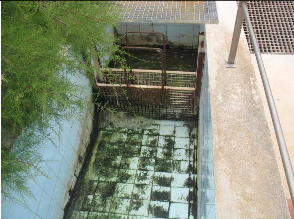
FOTO Nº49 Arqueta de salida de la EDAR.
