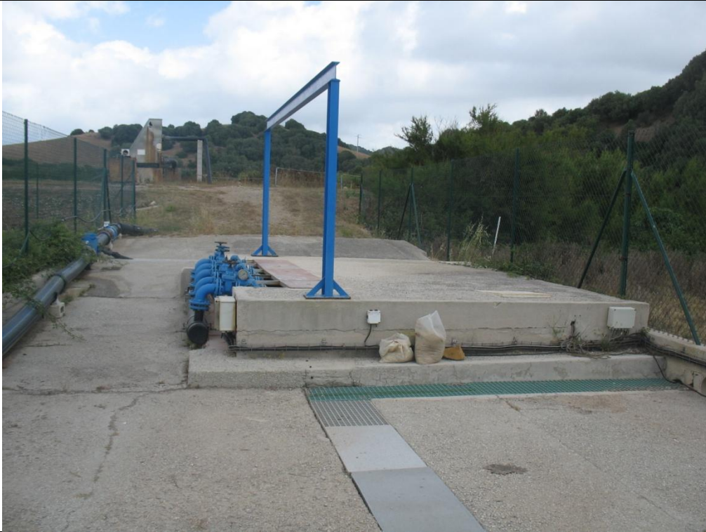
FOTO N°7 Pozo de bombeo del agua del núcleo de Es Mercadal.
