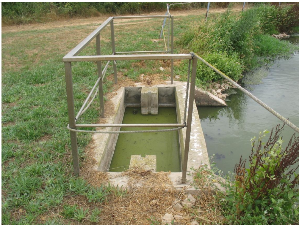
FOTO N°39 Cámara de compuertas de salida de la Laguna II a la Laguna III
