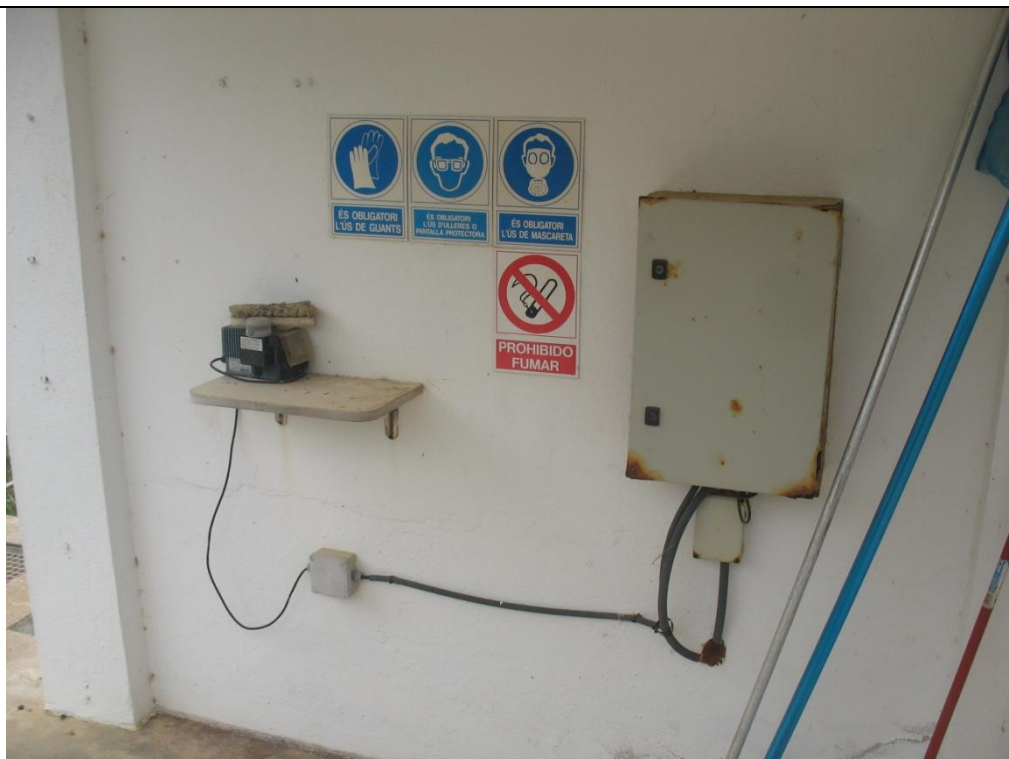
FOTO N°48 Cuadro eléctrico del equipo de cloración.
