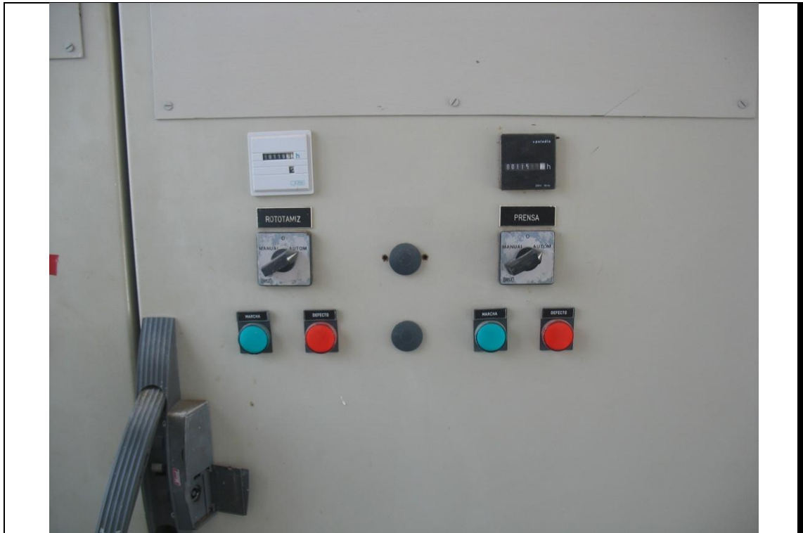
FOTO Nº29 Detalle del cuadro eléctrico del tamiz y el tornillo transportador-compactor.
