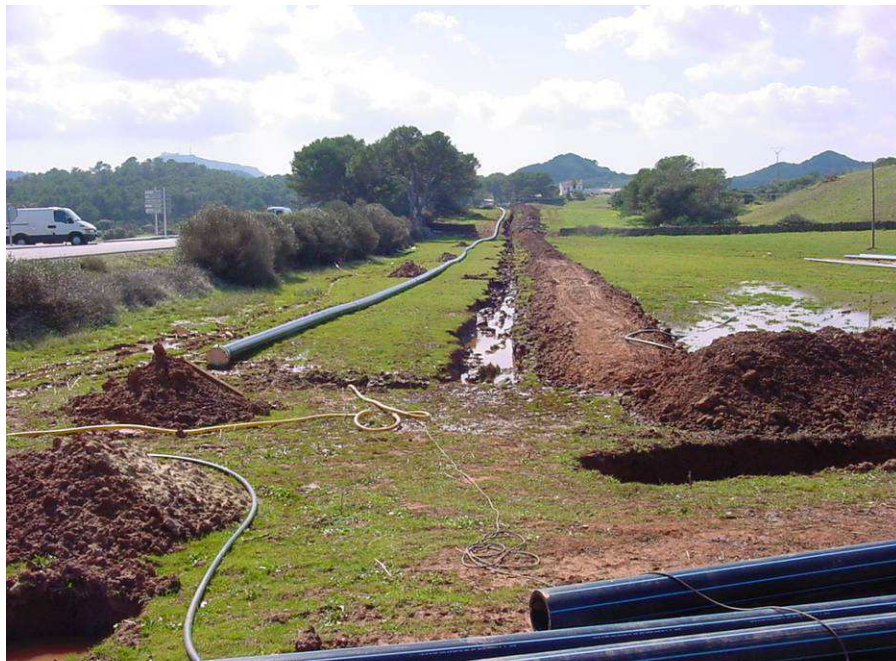
FOTO N°4: Vista de la instalación de la nueva tubería de impulsión desde la nueva EBAR de Sta. Victòria hasta la antigua.
