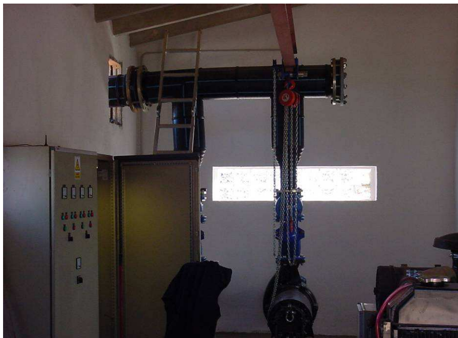
FOTO Nº2: Cuadro eléctrico de los bombeos.
