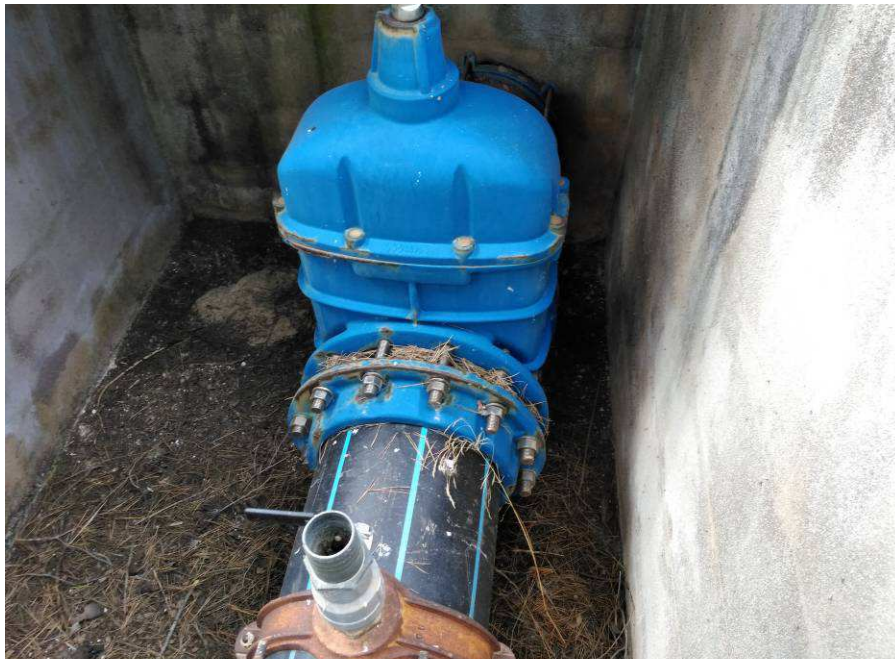
FOTO N°8: Válvula de corte DN300 instalada en la conexión de los dos tramos de tubería.
