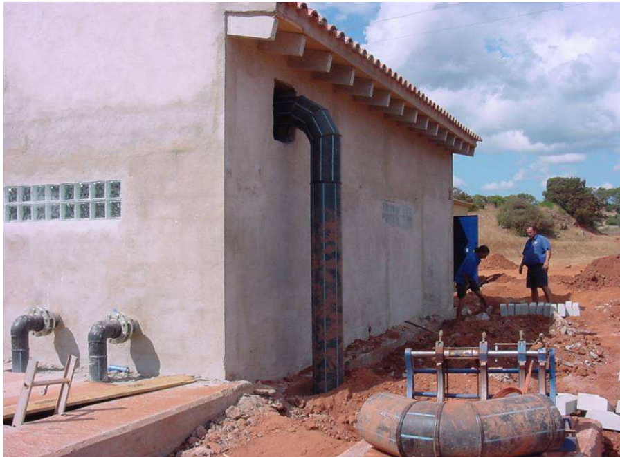
FOTO N°3: Vista de las tuberías de impulsión de los bombeos en cámara húmeda y conducción de salida de la estación.
