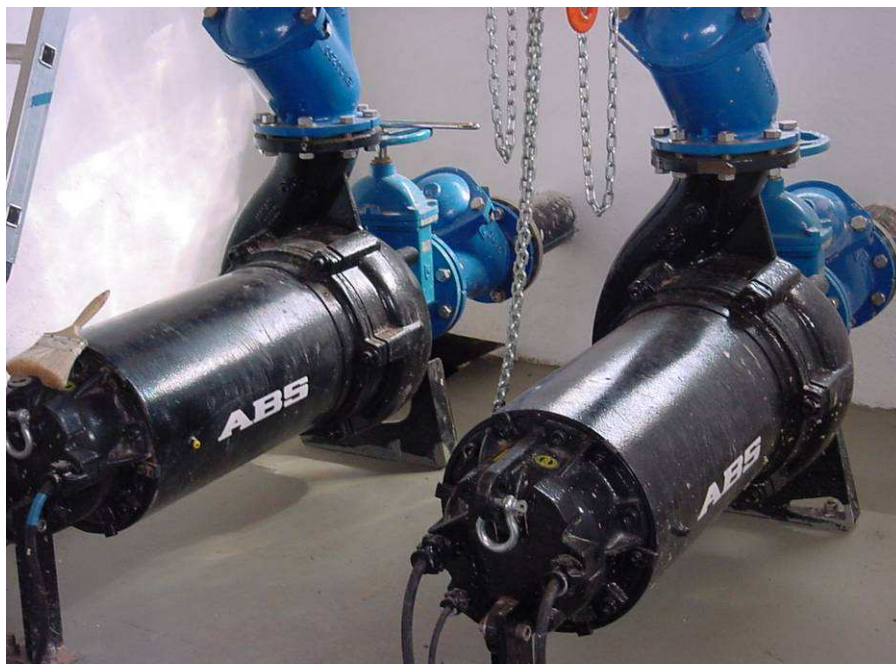
FOTO Nº1: Equipos de bombeo en seco instalados en la nueva EBAR de Sta. Victòria.
