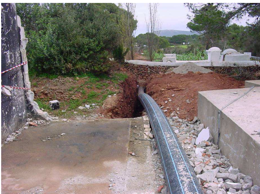
FOTO Nº6: Vista de la nueva tubería de impulsión a la altura de la antigua EBAR, que quedó afectada por un incendio.
