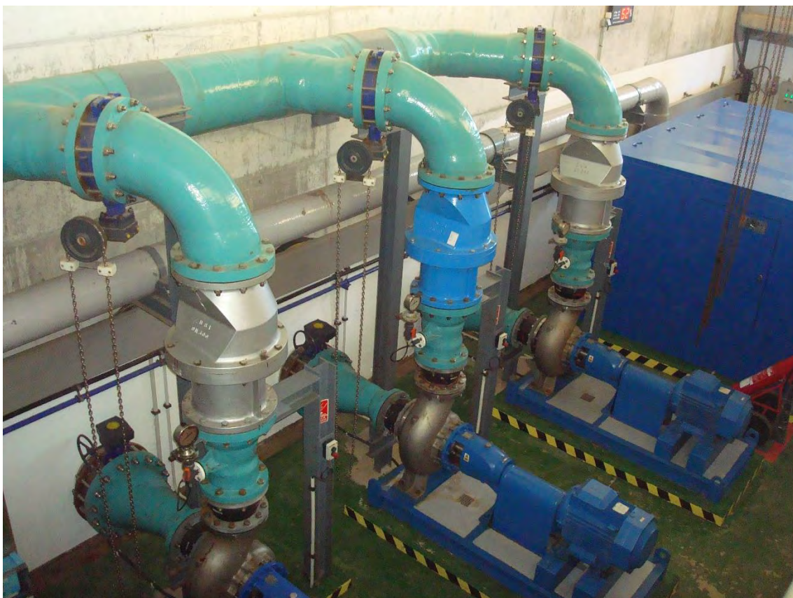
Filtración. Bombas de lavado de filtros
