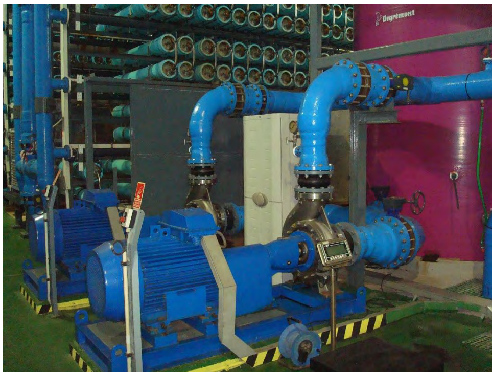
Bombas de lavado CIP
