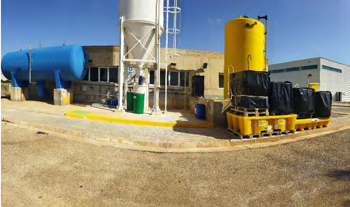
Dosificación reactivos post-tratamiento
