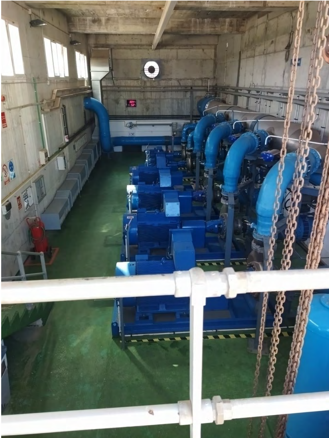
Bombeo de agua producto
