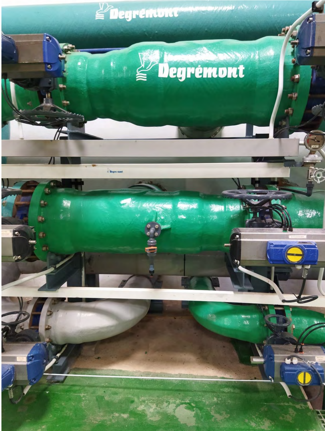
Filtración. Frente de filtros (interior de la nave)
