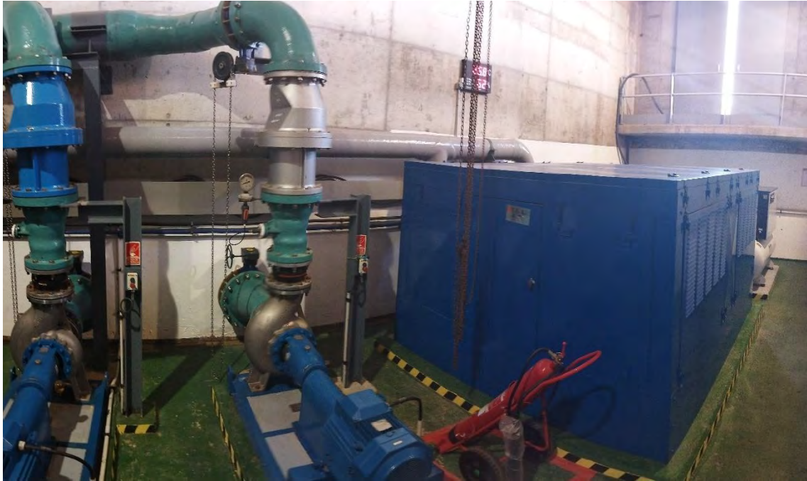
Filtración. Lavado de filtros
