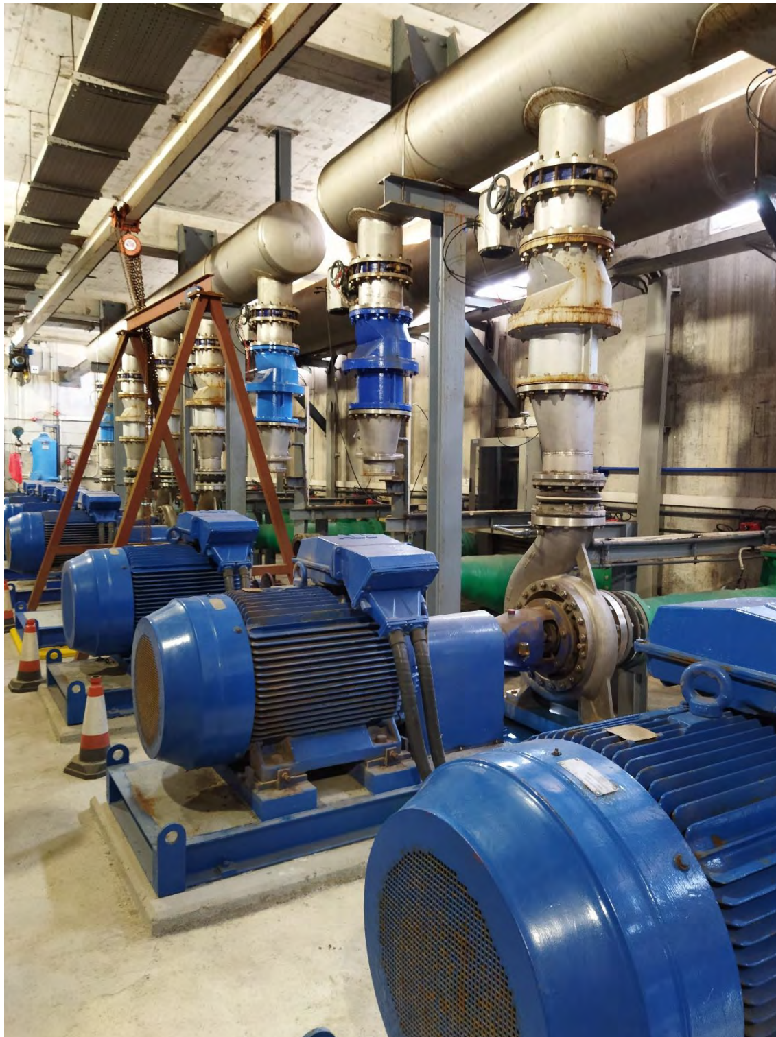
Bombas de agua bruta
