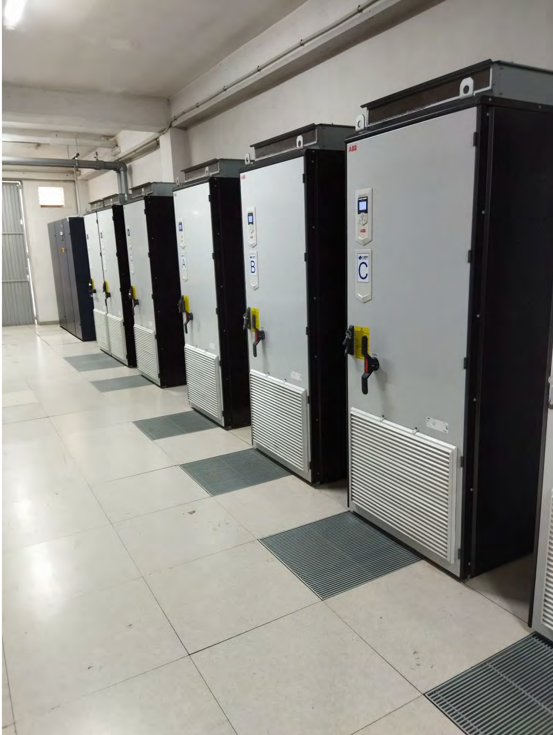
Sala de variadores del bombeo de agua bruta
