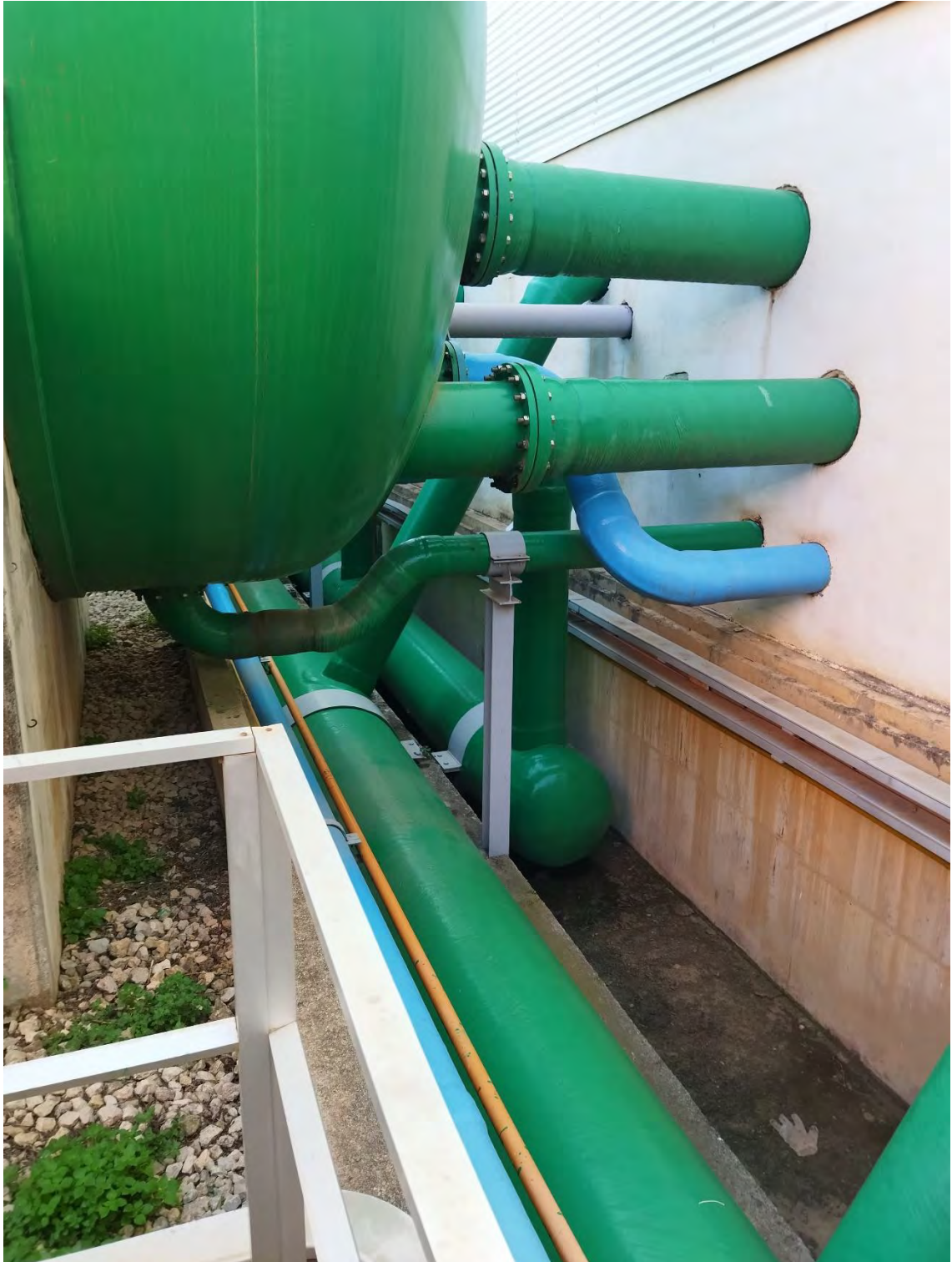
Filtración. Frente de filtros (exterior de la nave)
