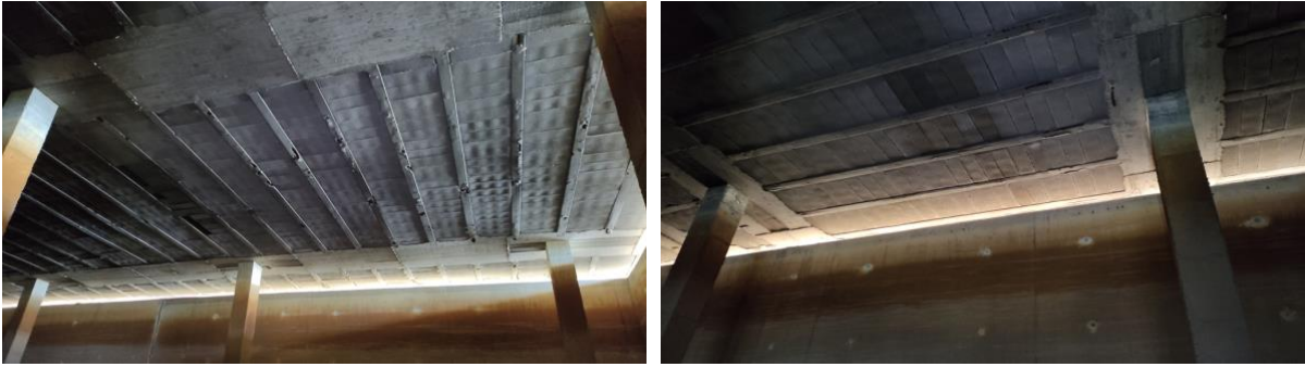
Foto 3 y Foto 4. Viguetas con desperfectos.
