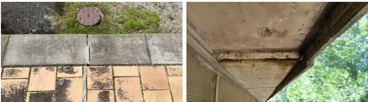
Foto 10 y Foto 11. Movimiento diferencial del módulo en sentido vertical y horizontal
