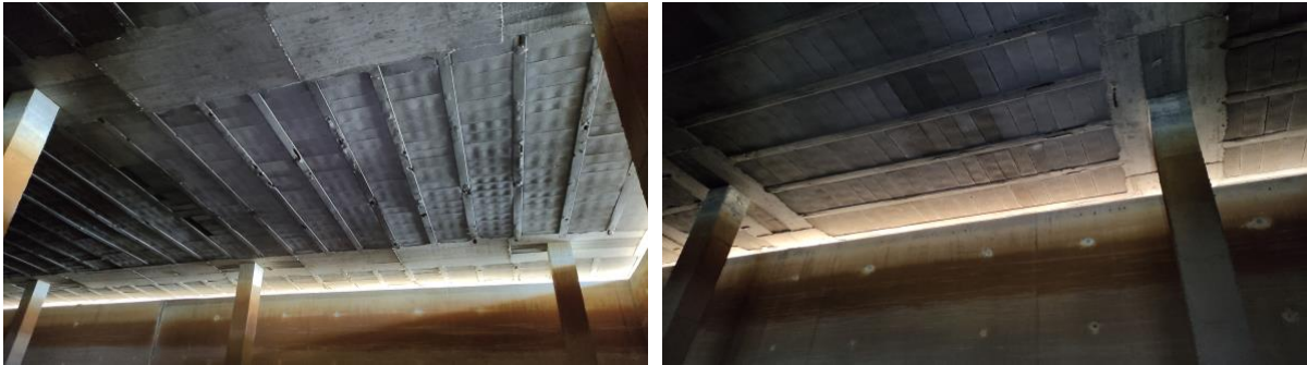
Foto 3 y Foto 4. Viguetas con desperfectos.
