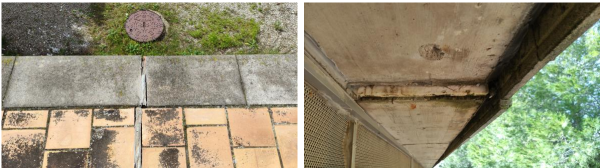
Foto 7 y Foto 8. Movimiento diferencial del módulo en sentido vertical y horizontal
