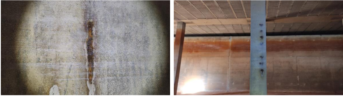
Foto 6 y Foto 7. Desperfectos en muros y pilares
