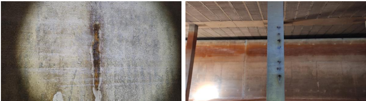
Foto 5 y Foto 6. Desperfectos en muros y pilares
