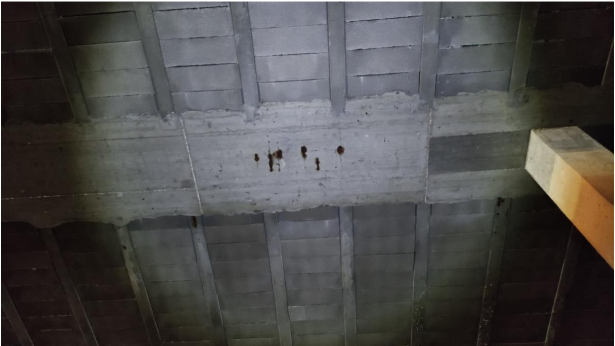
Foto 5. Deficiencias en jácenas
