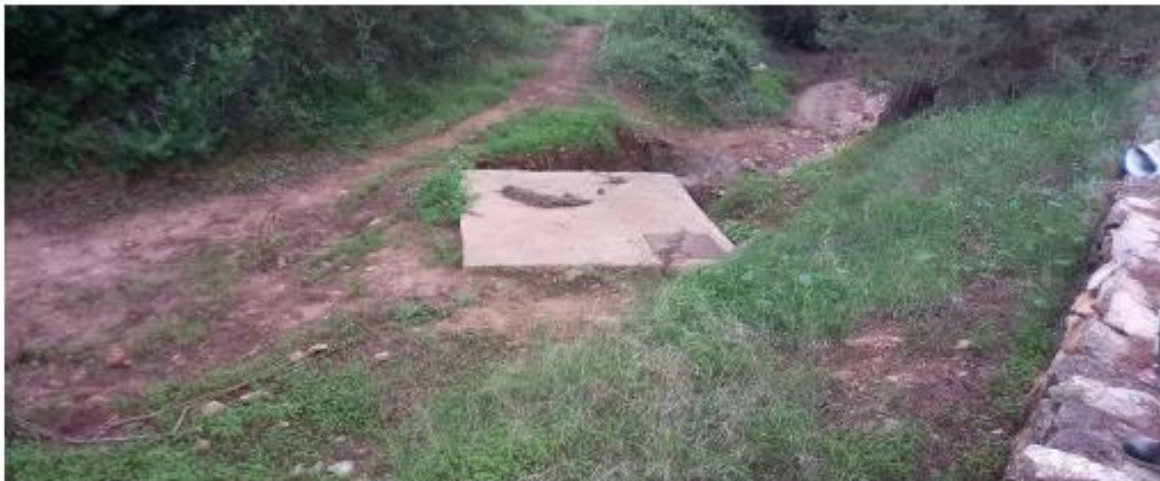
Fotografía 1 Grupo de fotografías del estado actual de la arqueta de desagüe existente en el Torrent de Labritja. Fuente: Elaboración Propia
