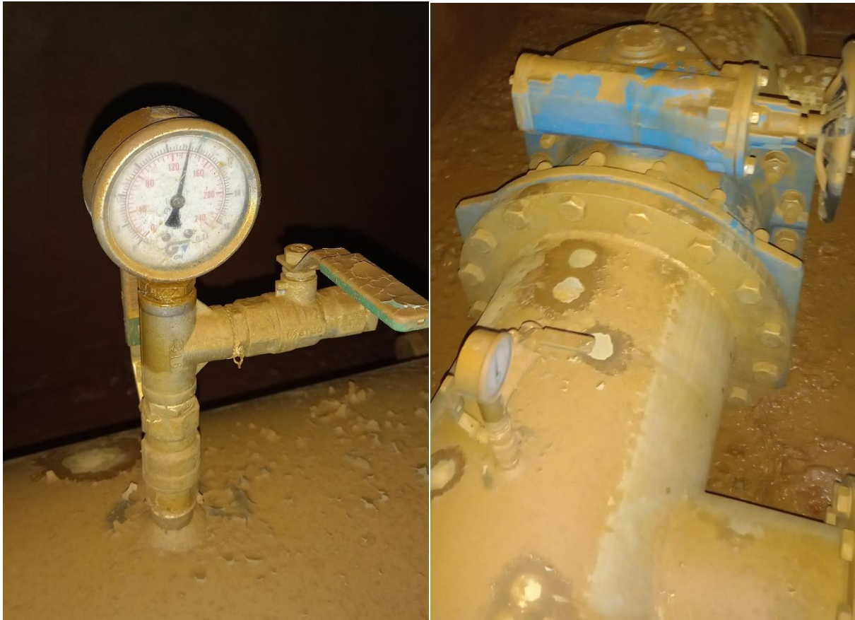
Ilustración 8.- Vista en detalle de la válvula de mariposa doble excéntrica instalada, salida del ramal de desagüe y manómetro
