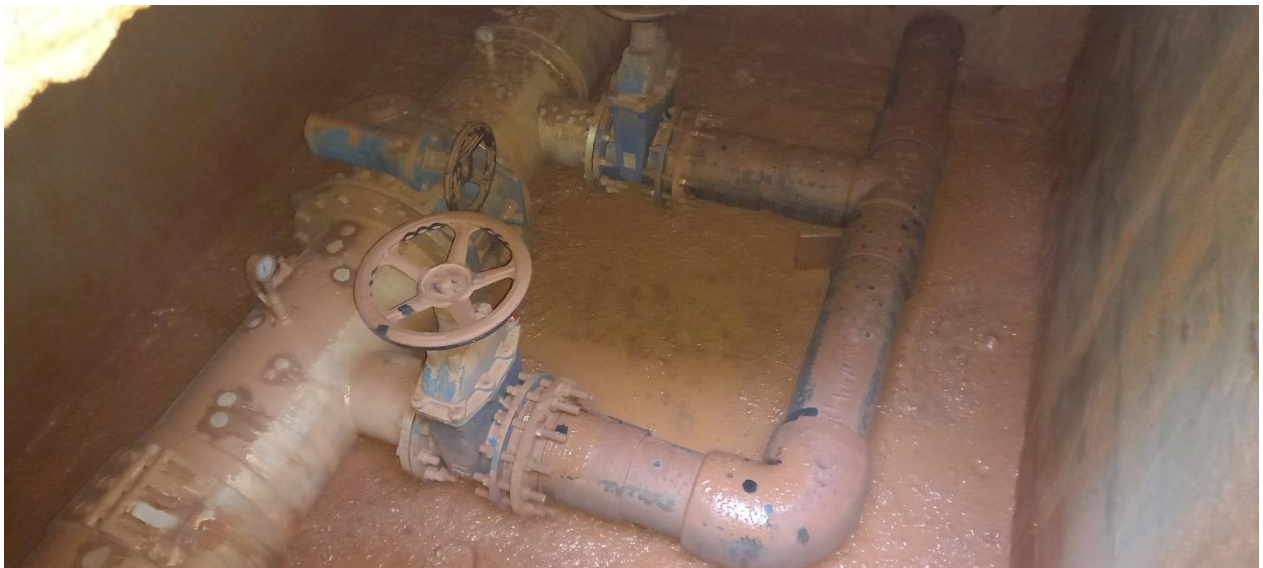
Ilustración 7.- Interior de la arqueta donde se puede observar el estado actual de los accesorios instalados y el tramo de desagüe
