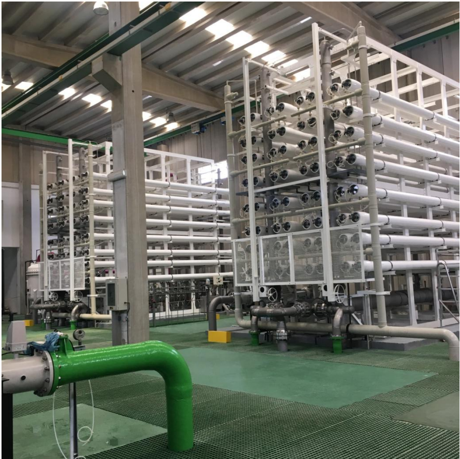
Foto 22 Bastidores de tubos de membranas
