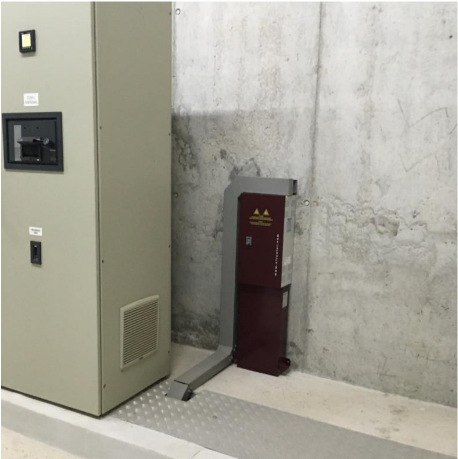
Foto 1 Condensador fijo de 60 KVAR en Cantara
