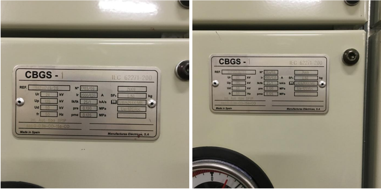
Foto 56 Placas de características Cabinas de 15 KV entrada salida en Subestación.
