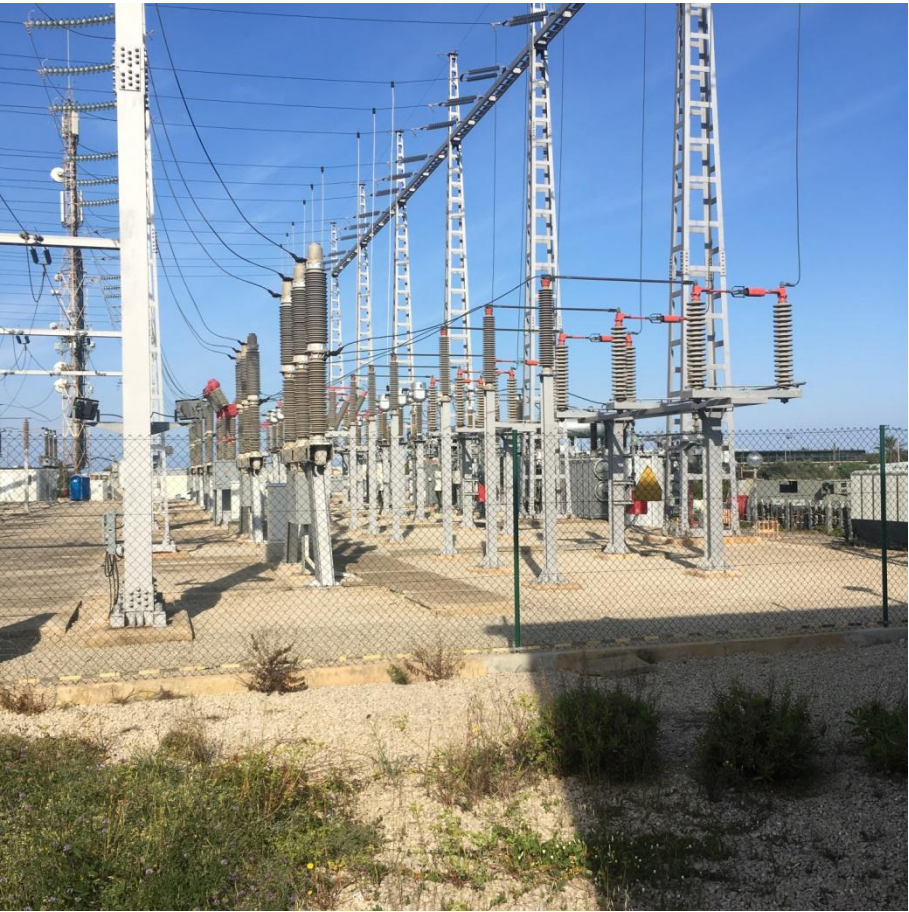
Foto 47 Vista general calles de 132 KV en SE Ciutadella.
