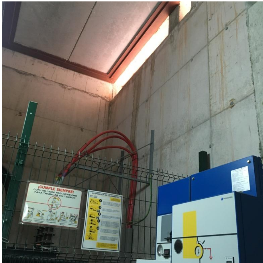
Foto 11 Trafo y celdas de Protección en CT subterráneo de Cantara.
