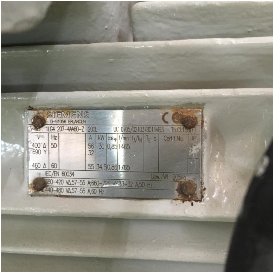
Foto 13 Placa de características Bomba de agua de lavado junto a bombas efluentes.
