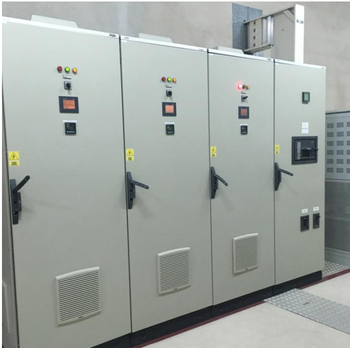
Foto 18 Cuadros de mando Bombas Alta Presión
