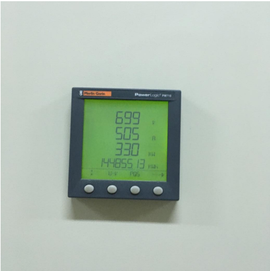
Foto 58 Analizador de redes con parámetros eléctricos Bomba Alta Presión nº 1 durante avería
