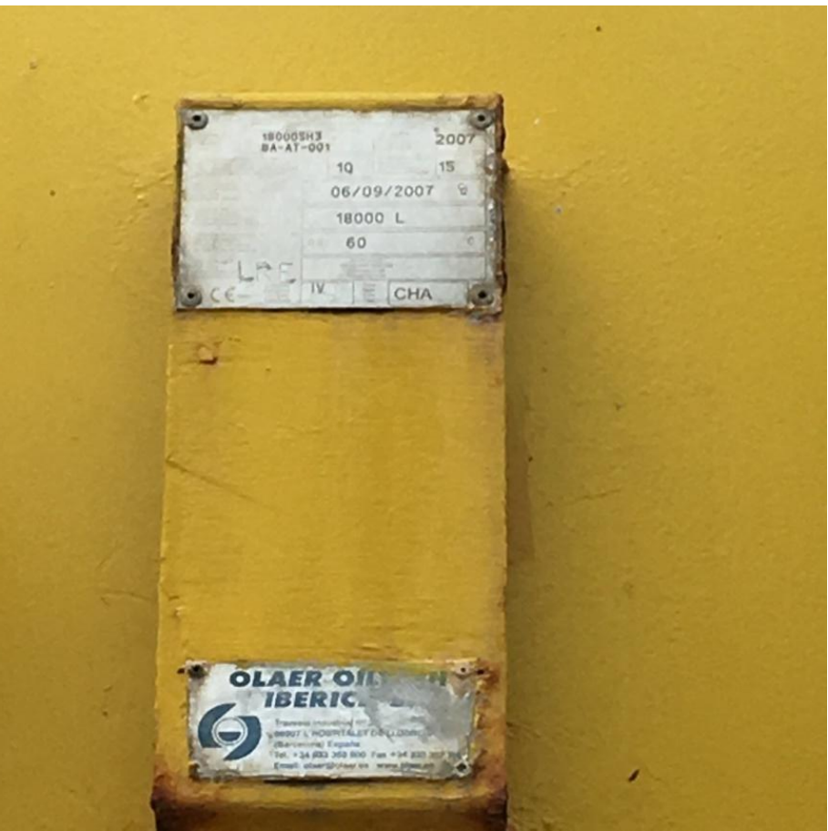
Foto 31 Placa características equipo antiarriete bombeo agua tratada
