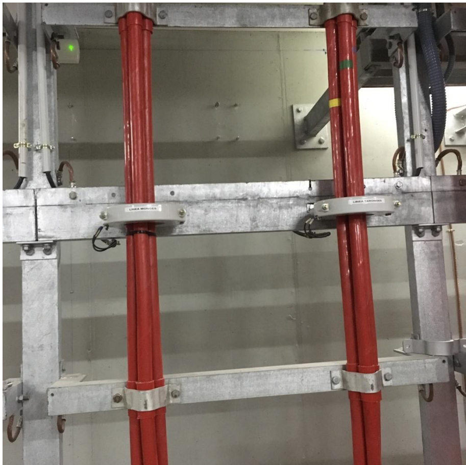
Foto 54 Detalle entrada salida líneas MONGES Y TARONGES 15 kv en suelo técnico.
