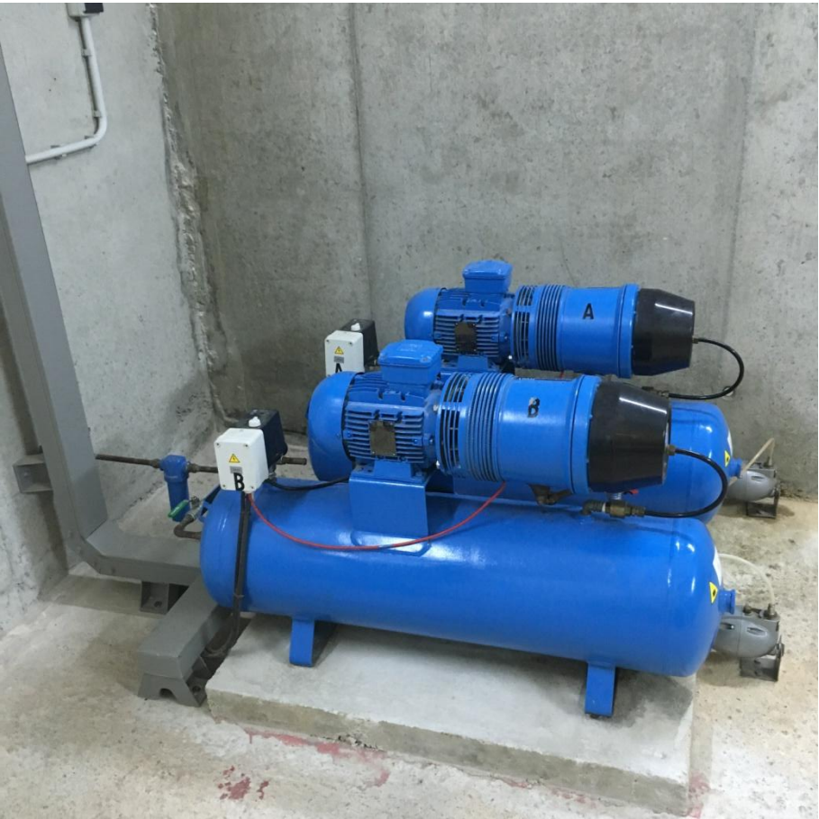
Foto 35 Detalle compresores en Cantara y bancada.
