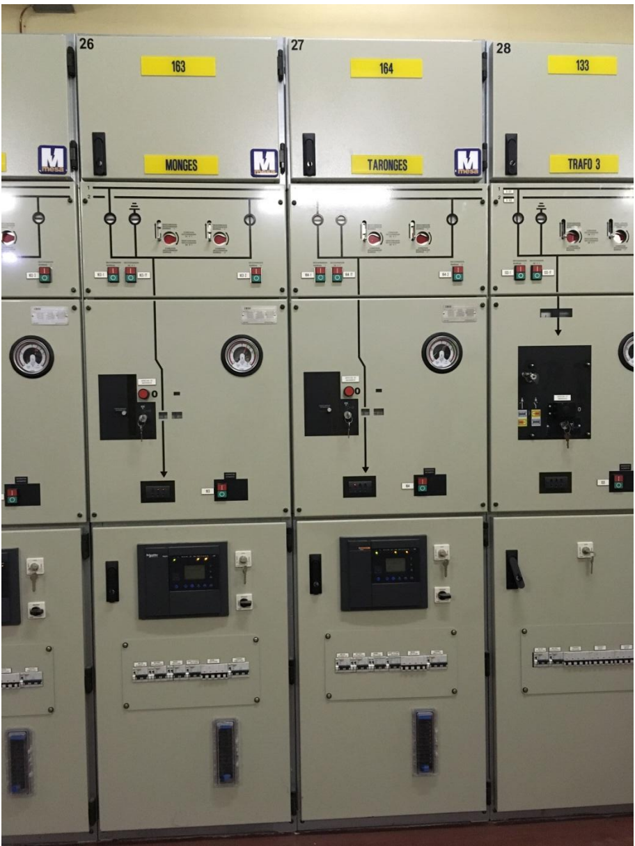
Foto 55 Cabinas 15 kV en subestación entrada salida líneas MONGES Y TARONGES alimentación a Desaladora.
