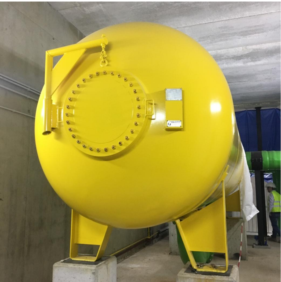
Foto 33 Equipo anti ariete bombeo captación.
