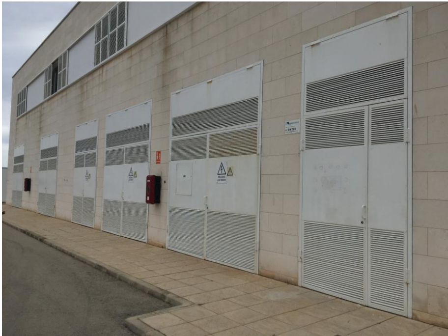
Foto 42 Exterior habitaciones destinadas a ubicación de instalaciones de MT en Desaladora.
