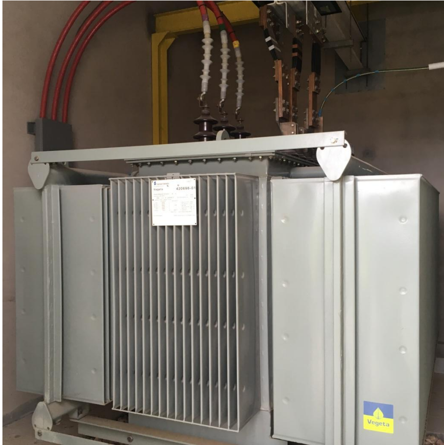
Foto 45 Transformador 3150 KVA 15/0.69 KV alimentación a Bombas Alta Presión cuadro CCM I6
