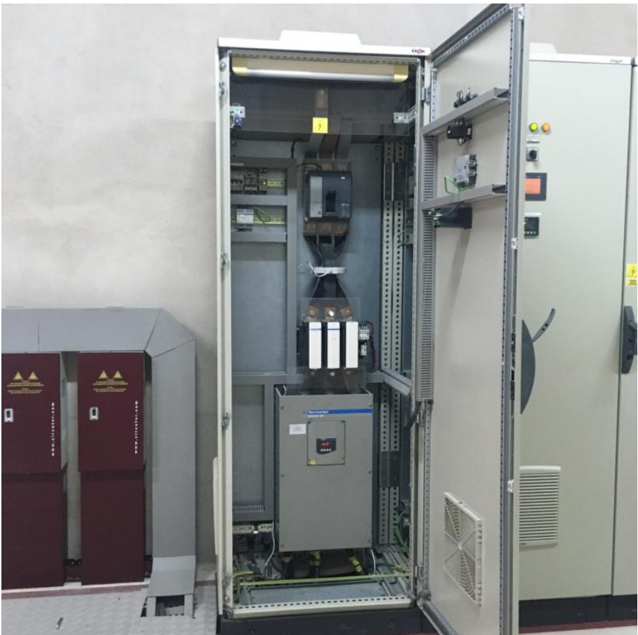
Foto 19 Interior cuadro protección Bomba Alta Presión
