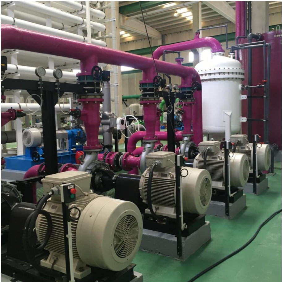
Foto 24 Bombas de Lavado Y desplazamiento (Limpieza de 55 kW c/u)
