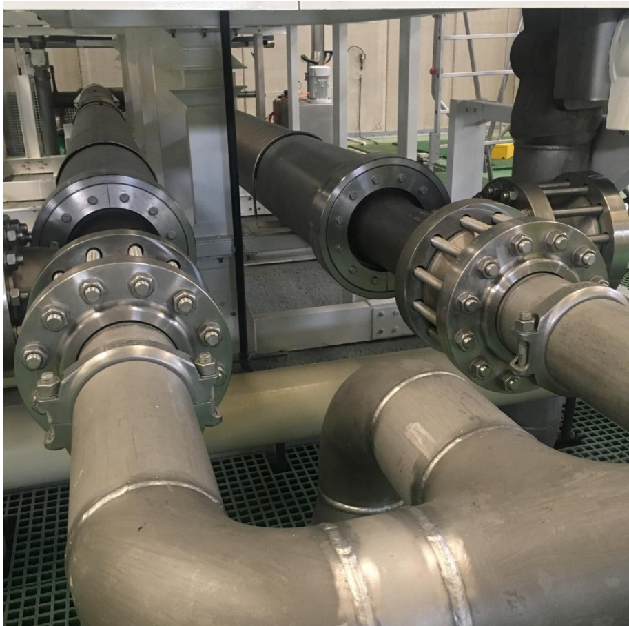
Foto 23 Intercambiador de presión DWEER (CALDER) MOD. 1100
