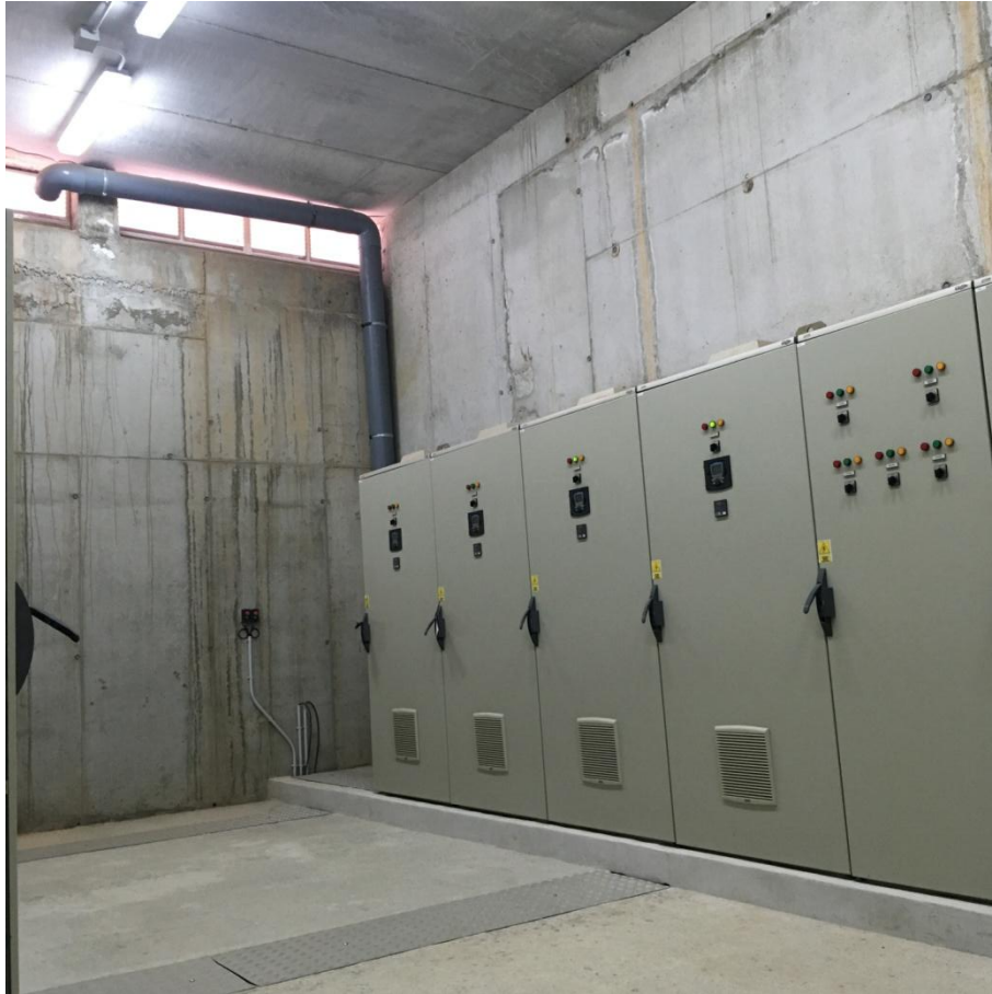
Foto 7 Tubería para ventilación sin conectar en sala cuadros eléctricos de Cantara.
