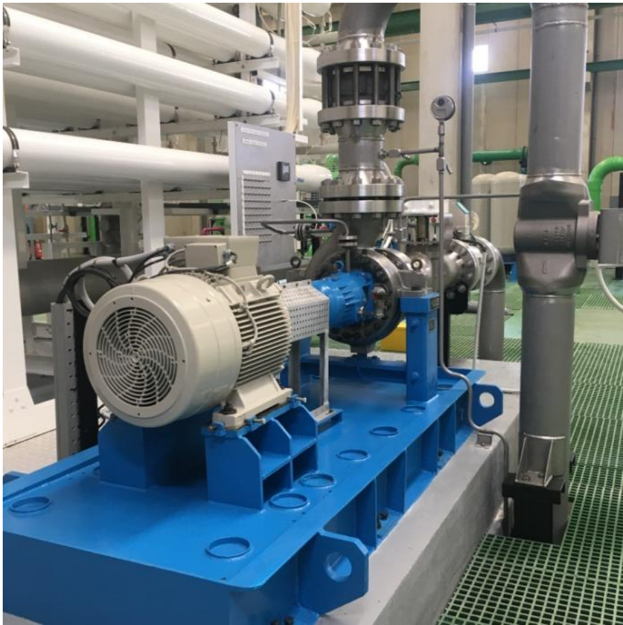
Foto 20 Bomba BOOSTER 37 kW
