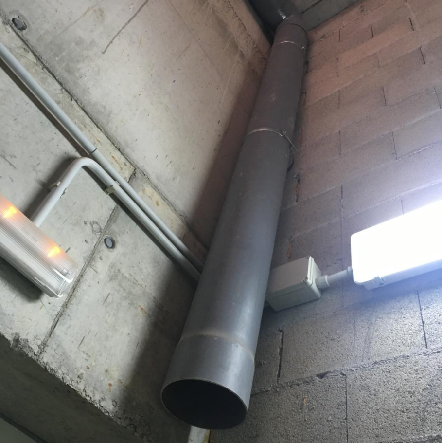
Foto 6 Tubería para ventilación sin conectar en sala Transformadores de Cantara.
