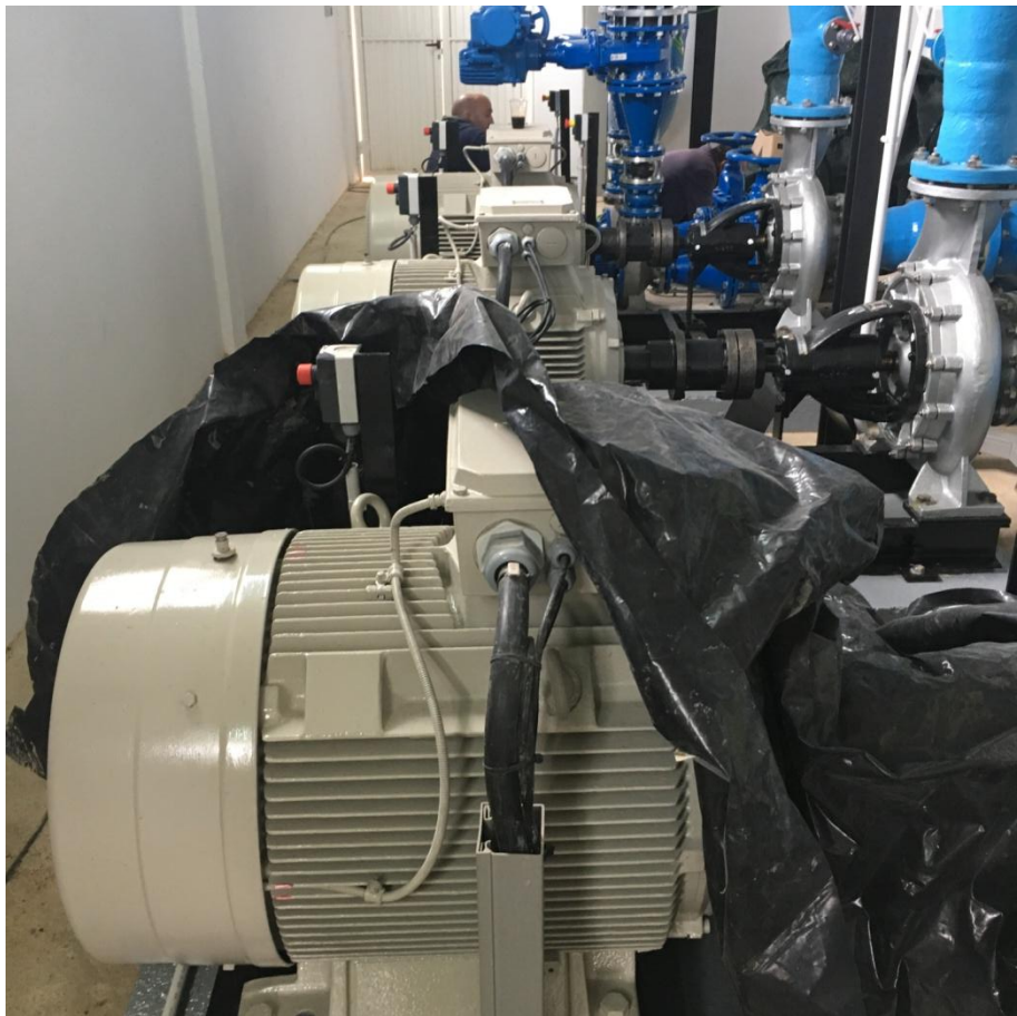
Foto 26 Bombas bombeo a Depósitos municipales 75 kW c/u
