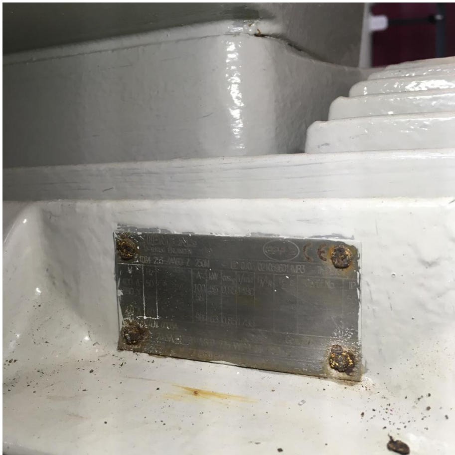
Foto 25 Placa de Características Bombas de limpieza y desplazamiento 55 kW.
