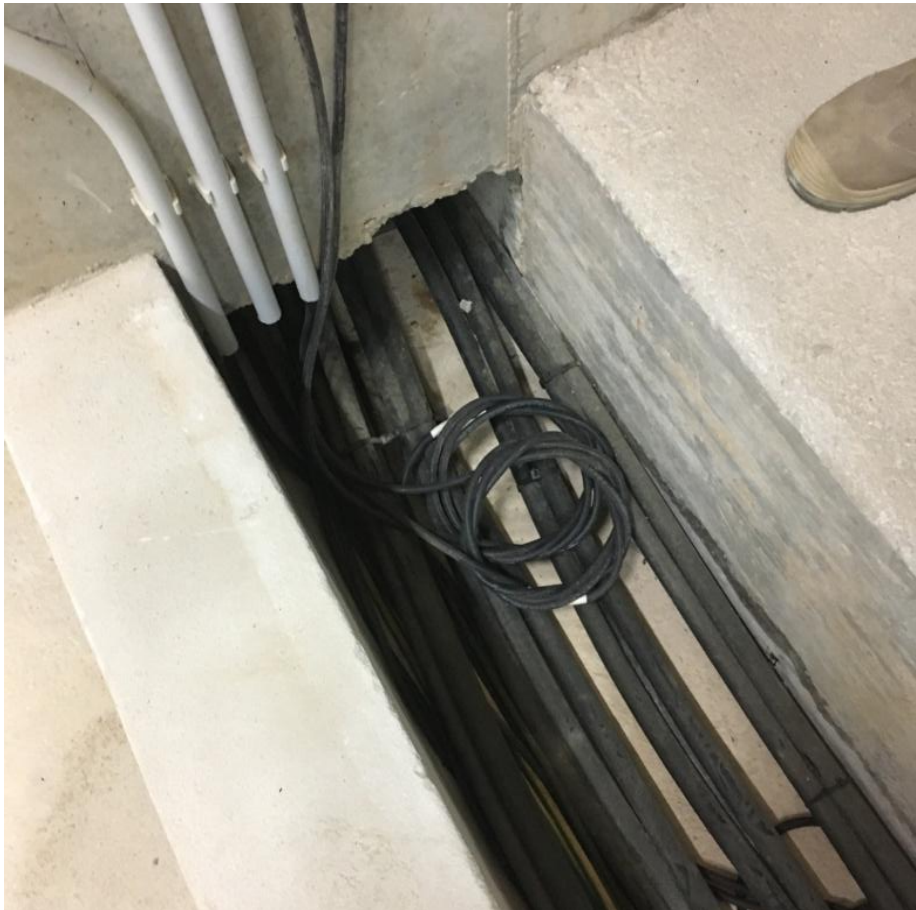
Foto 5 Conductores sin conectar en Edificio Cantara
