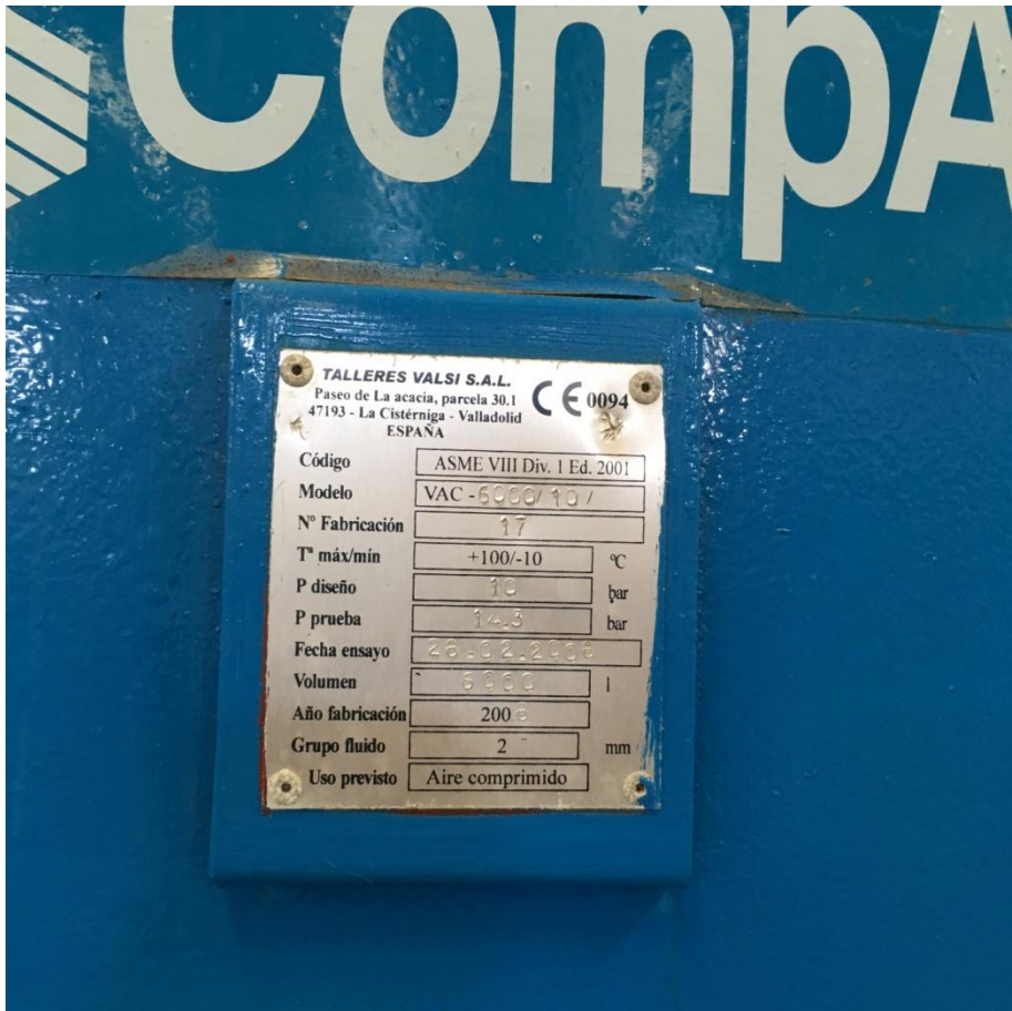
Foto 30 Placa de características depósito aire comprimido.
